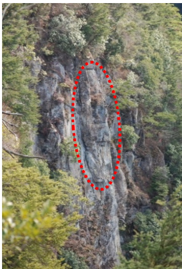
崩落対象岩塊群
